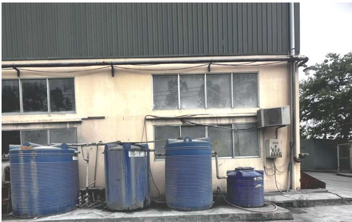
Hình 3.4. Hình ảnh minh họa hệ thống xử lý nước thải của cơ sở.
